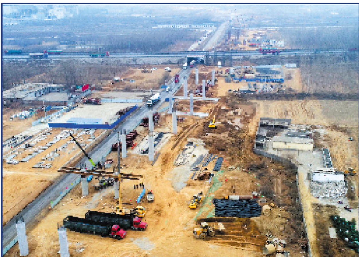
石家庄山前大道拓宽改造二期控制性工程跨石大高速分离式立交桥进入基础施工,标志着该项目桥梁下部结构进入新阶段。据了解,该特大桥将于4月10日完成下部结构施工。
