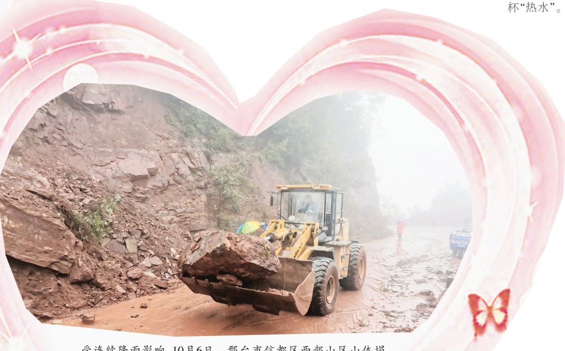
受连续降雨影响,10月6日,邢台市信都区西邢山区山区塌方,国道G340 K562+700处公路断交。邢台市信都区交通运输局立即行动,紧急调派抢险人员,机械赶赴现场展开抢险抢通工作。经过5个小时连续奋战,于当日11时40分,道路恢复通行。
