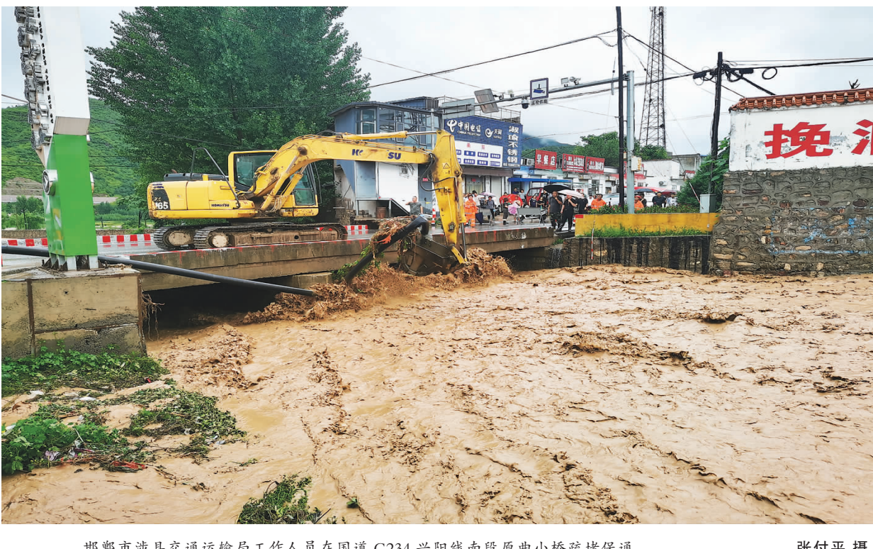
邯郸市沙县交通运输局工作人员在国道G234兴阳线南段原曲小桥疏堵保通。
