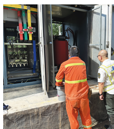
工作人员正在对机电系统进行检查。
