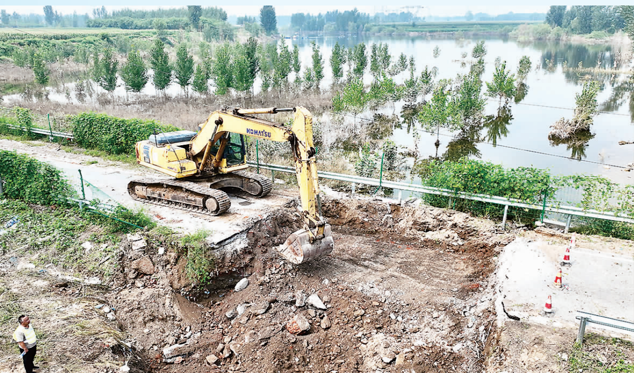
涿州市交通运输局对东城坊镇边庄学校路进行破除重建。
