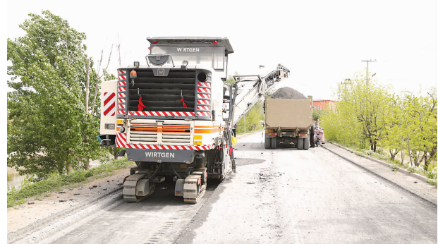
近日,沧州黄骅市交通运输局科学调配施工力量,克服多点施工、多线作战、技术力量分散等问题,严把疫情防控和施工质量关,全力推进市道改梅路、国道G205等项目建设。据了解,该市2022年农村公路建设总里程约24公里,总投资约6615万元。图为建设者正在铣削路面。
